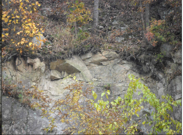
붕괴부 상단 균열 및 썩기파괴
